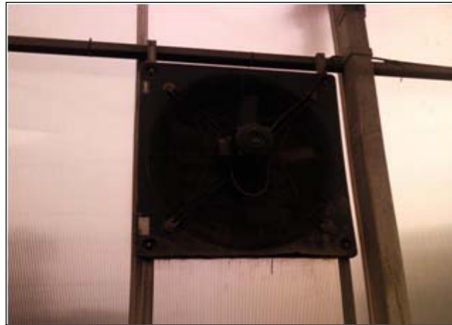
Fotografía 5. Extractor de aire
