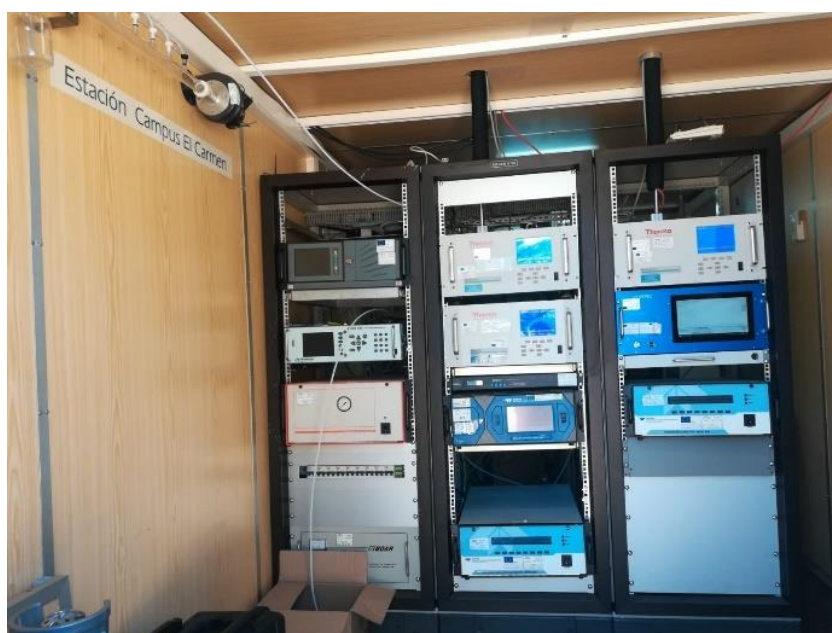
Figura 3.4.- Interior de la estación Campus en el Campus Universitario del Carmen donde se aprecia la instrumentación on-line.
