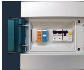
Figura 8. Protecciones AC. Fuente: Enelgreen.
